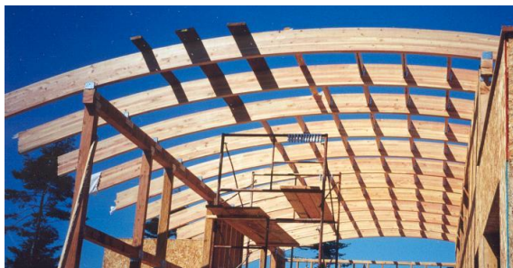
Grinzi lamelare cu rol structural într-o construcție din lemn
